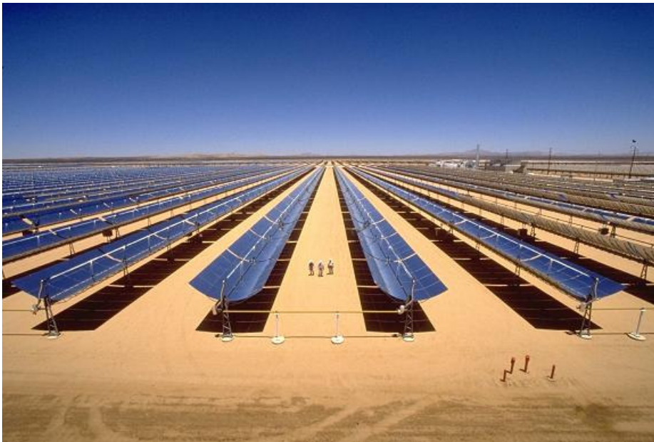
Luftbild der solarthermischen Parabolrinnen- Kraftwerke bei Kramer Junction in der Mojave-Wüste in Kalifornien, USA
