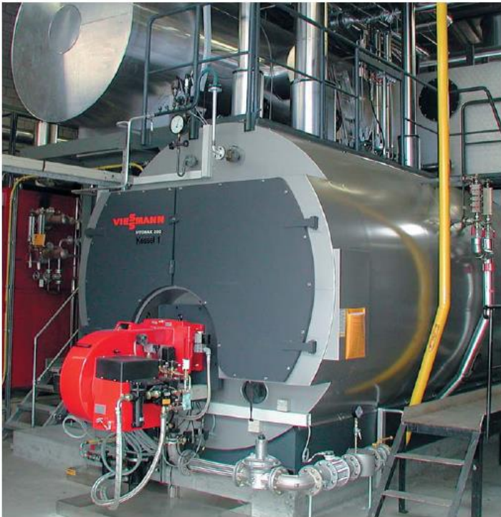
Bild 2: Dampferzeuger mit einer Dampfleistung von 4 t/h, 13 bar, mit integriertem Abhitzezug für ein BHKW mit 0,4 t/h (Abhitzeleitung noch nicht angeschlossen)
