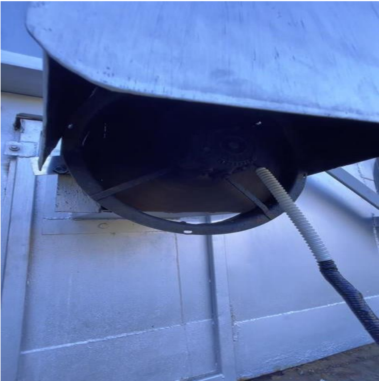
Air supply fan AF1 pic
