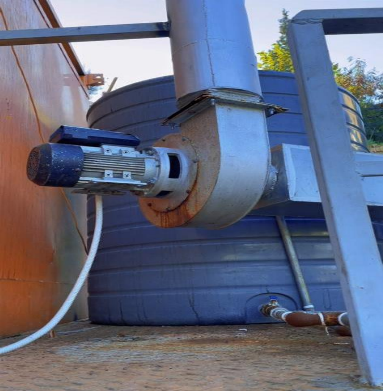
Exhaust fan E2 pic
