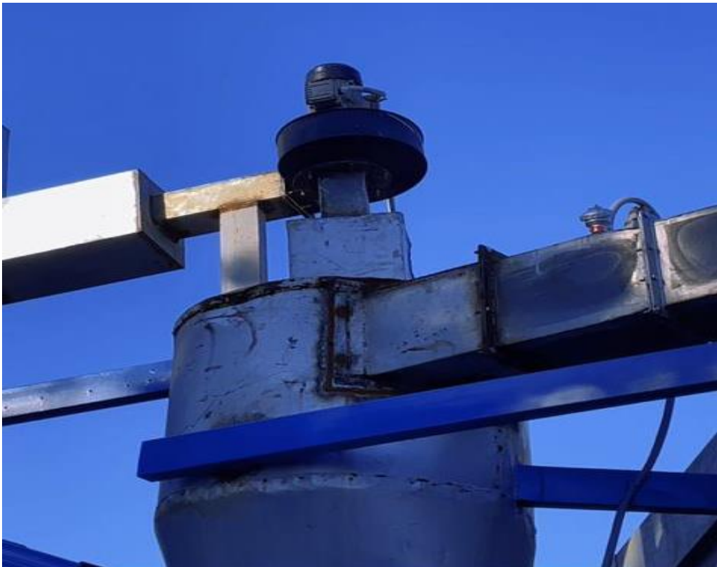
Exhaust fan E1 pic
